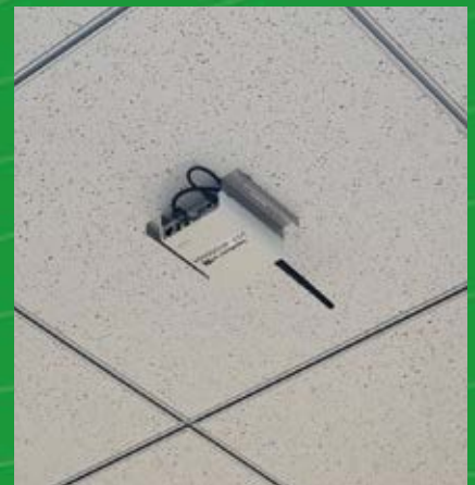
天井面に設置されている OpenBlocks IoT EX1
