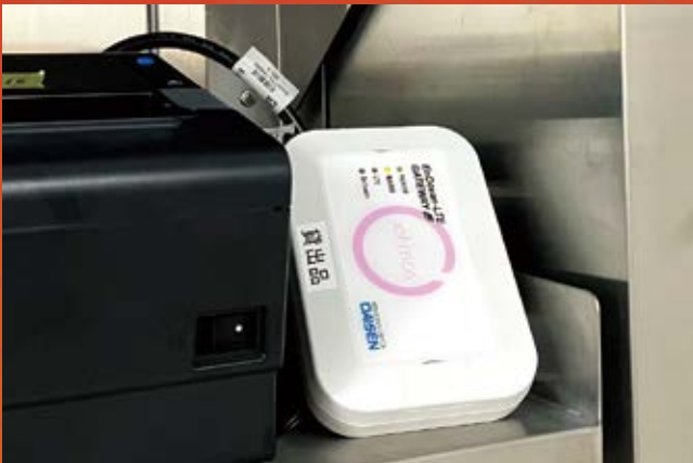
マルチセンサーの設置（冷蔵室内）
