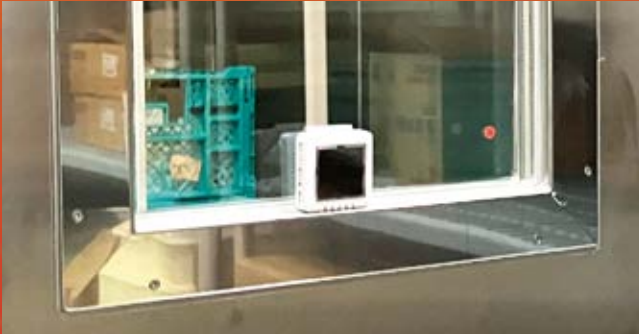
マルチセンサーの設置（冷蔵室内）
