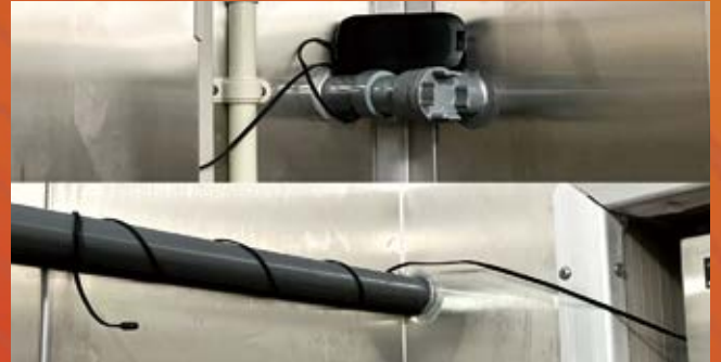
サーミスターの設置（冷凍室内）
