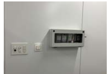
会議室ごとにコントローラを設置
