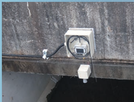
水位センサー設置状況
