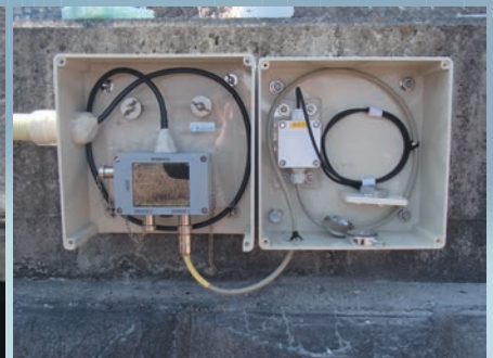
傾斜センサー設置状況
